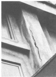
写真2 柱(D・11)のひびわれ
