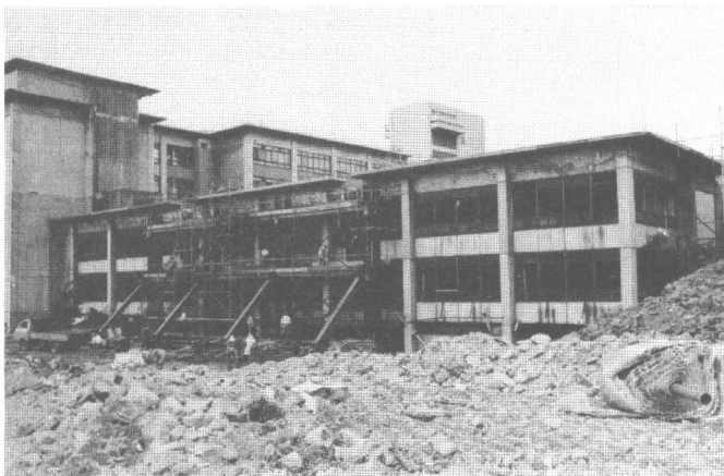
写真1. 研究棟の全景 (地下部分が露出している、中央の鉄骨は足場兼、変形測定用の不動点である)
