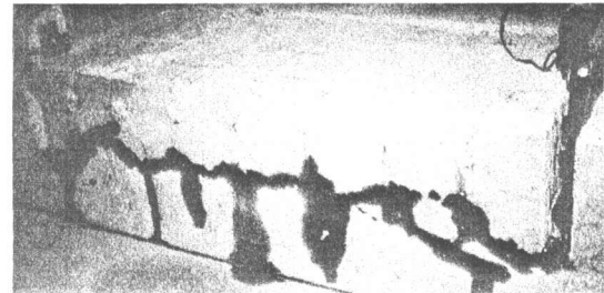
写真-6 側面ひびわれより水の浸出
