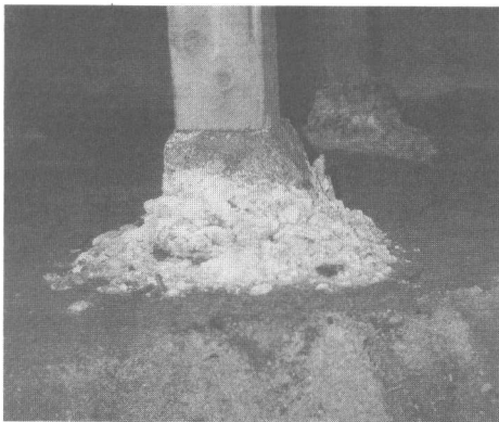
写真-1 調査対象家屋の床下状況
