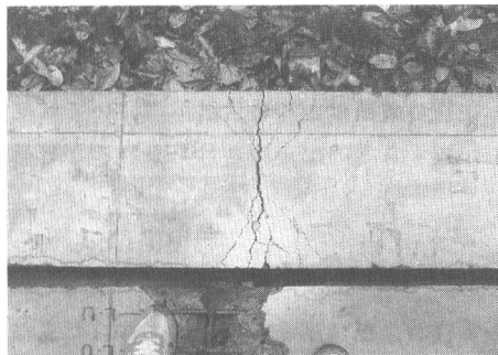
写真-3 鉄筋の破断によるひびわれ形状
