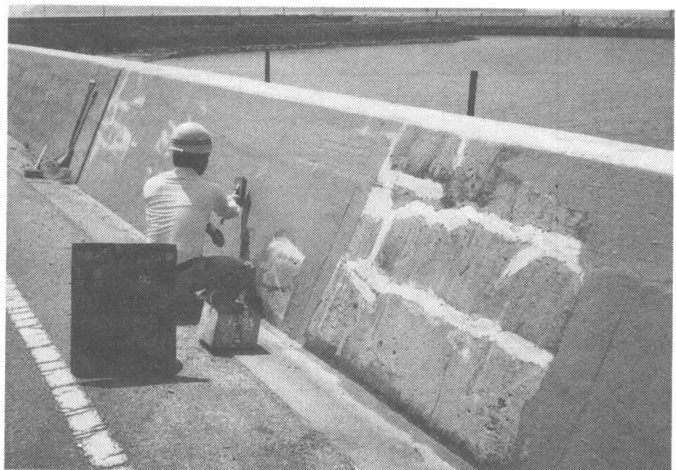
写真-2 アルカリ骨材反応の補修状況
