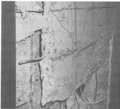
写真-1 鉄筋間ひびわれの確認
