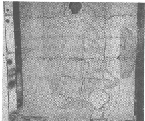
写真-2 加力によるひびわれ発生状況
