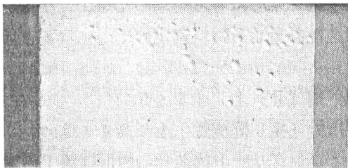
写真-3 ふくれの発生状況
