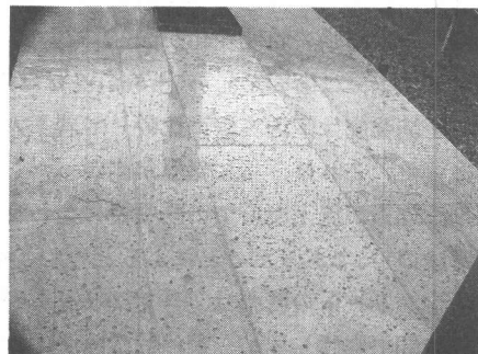
写真-2 コンクリート天端面の気泡
