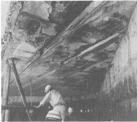
写真-1 既設構造物の劣化状況
