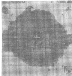
写真-5 裏面状況 (SRC-1)
