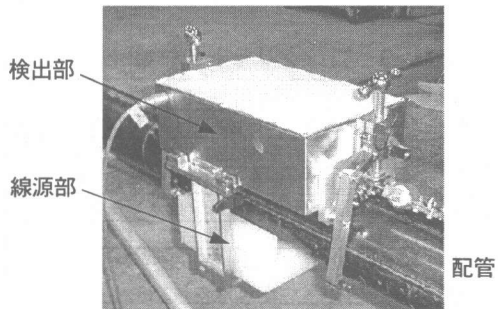
図-1 RI水分計本体の取付け状況
