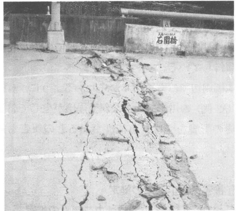
写真-6 卓欄線 A1 橋台付近の損傷
