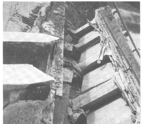
写真-2 A2橋台支承付近の損傷
