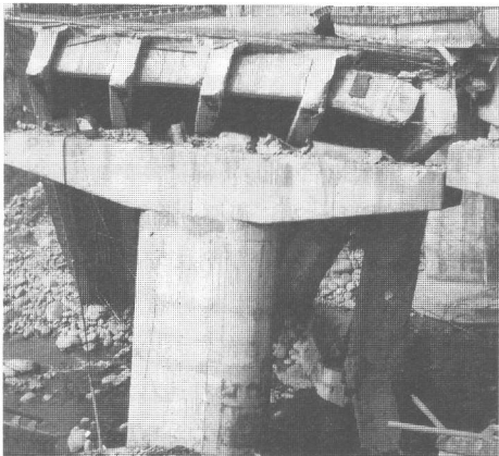
写真-4 東勢線 P2 橋脚の直角方向への傾斜
