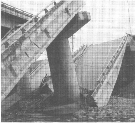
写真-3 東勢線 P2 橋脚の橋軸方向への傾斜
