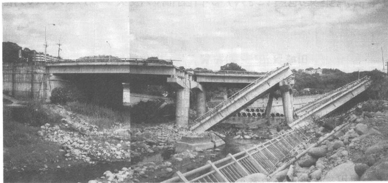
写真-1 石圍橋の被害状況
