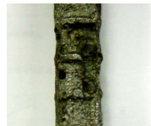
写真 - 2 引張鉄筋の腐食状況 (梁 FA)
