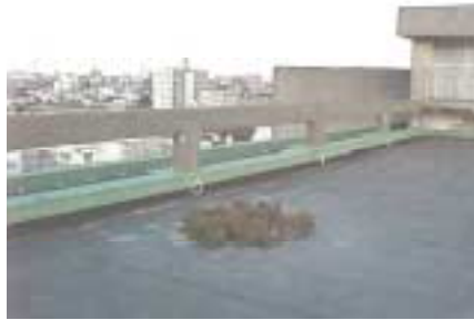
図-2 中性化している部材の全景
