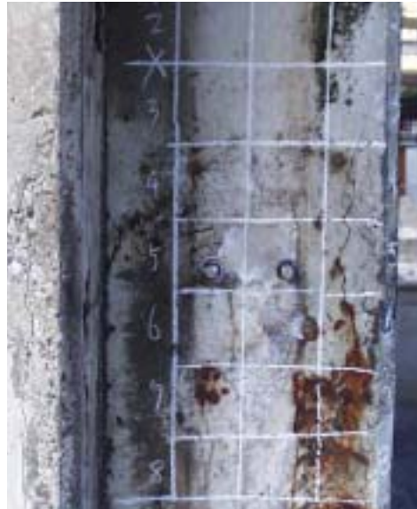
写真 - 1 柱部材の劣化状況
