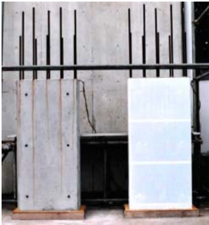
写真 - 7 保水テープ貼付による汚れ防止効果 (左：錆汁による汚れ，右：保水テープ貼付)
