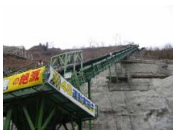
写真-1 運搬設備
