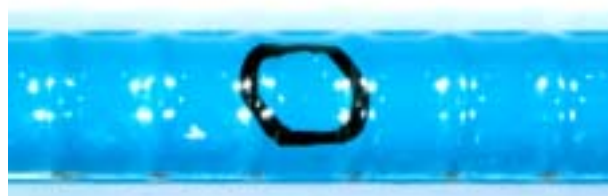
写真-4 エポキシ樹脂塗装鉄筋のピンホール
