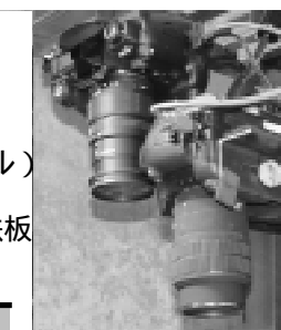
図-5 カメラ設置状況
