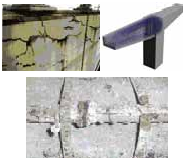
図-1 折曲げ部の破断状況 3)
