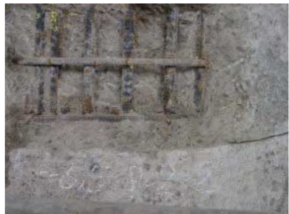
写真-2 鉄筋腐食状況 (H.W.L. -6.5m 付近)
