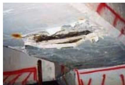
写真-1 栈橋上部工の再劣化状況
