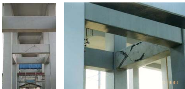
図 4.2 R7 高架橋の被災状況
