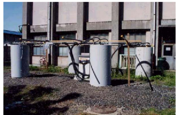
写真-1 暴露状況
