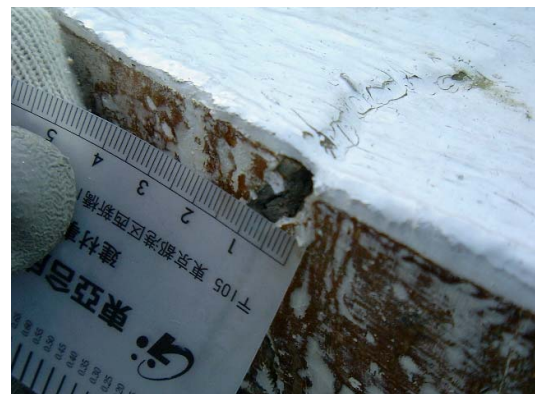
写真-2 アクリルゴムのひび割れ追従状況
