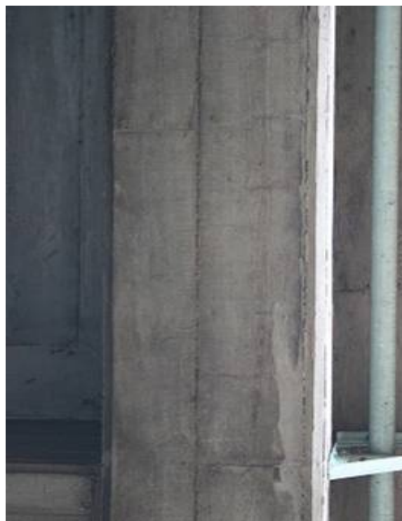
写真-3 2行目の劣化部位
