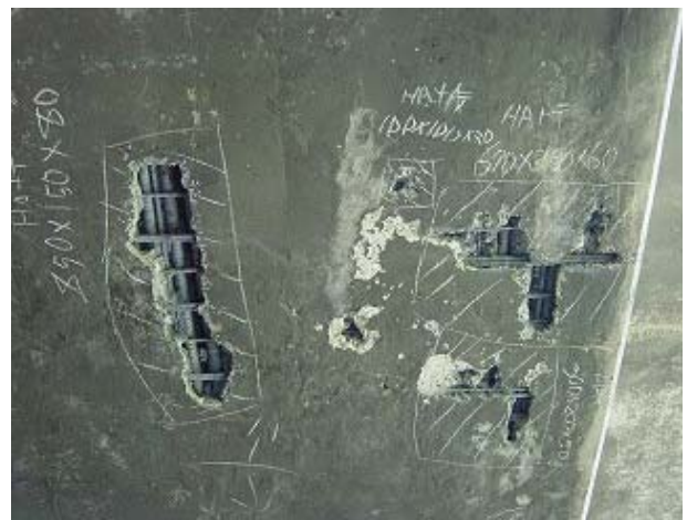
写真-5 d 橋剥離部分
