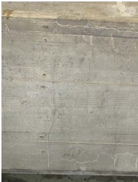
写真-1 桁の下面に見られるひび割れ
