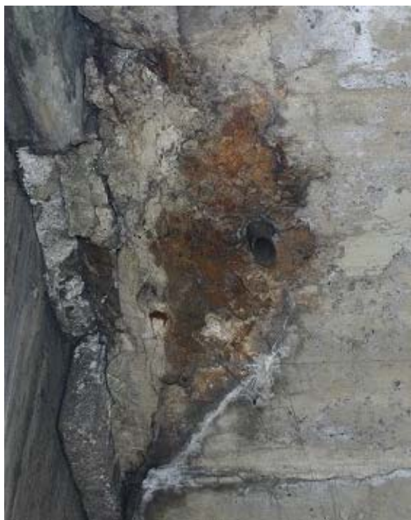
写真-2 1行目の劣化部位
