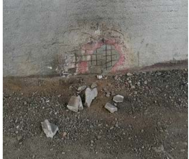
写真-8 吹付けコンクリートの剥離
