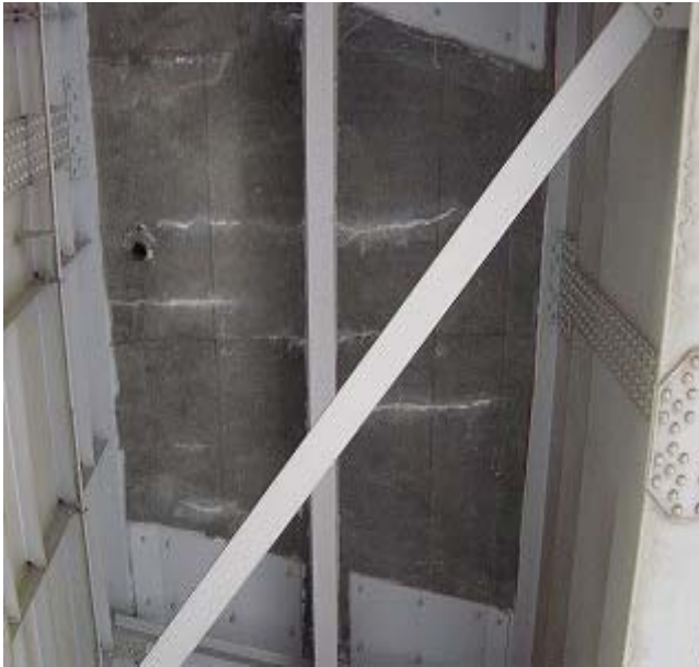
写真-10 I橋 RC床版のひび割れ
