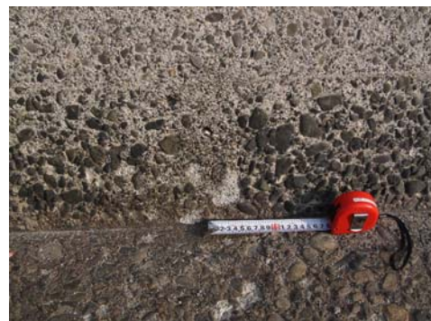
図-1 農業水路の摩耗状況
