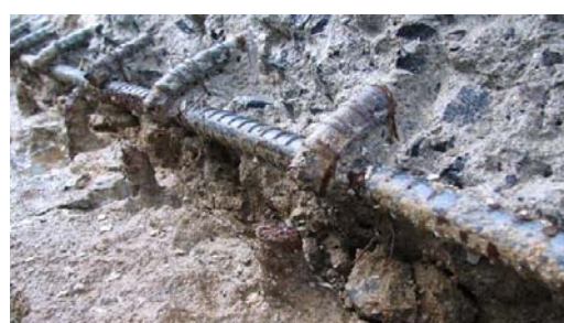
写真-2 橋脚フーチング端部の鉄筋破断
