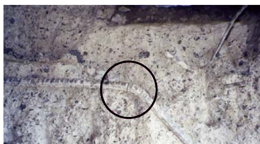
写真-1 橋脚梁（折り曲げ鉄筋）の鉄筋破断
