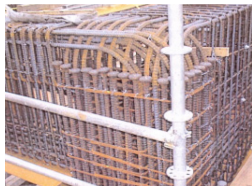
写真-2 過密配筋の状況
