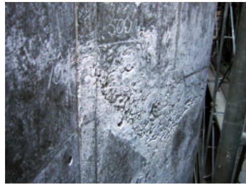
写真-1 側壁部における締め固め不足によるジャンカの例
