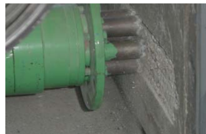
写真-2 機械的切削工法における切削状況 (KA-95 使用の場合)
