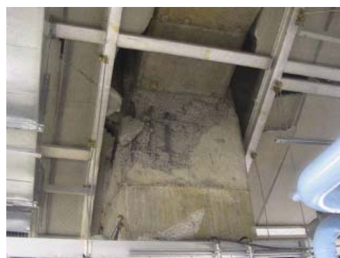
写真-2 柱 (b) 損傷状況
