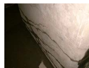
写真-5 柱 (d) 基部損傷
