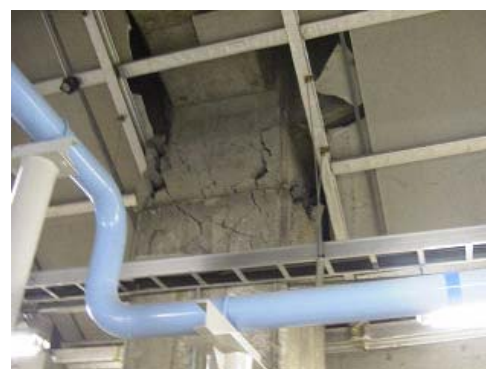
写真-3 柱 (c) 損傷状況
