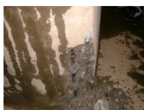
写真-4 柱 (d) 基部損傷
