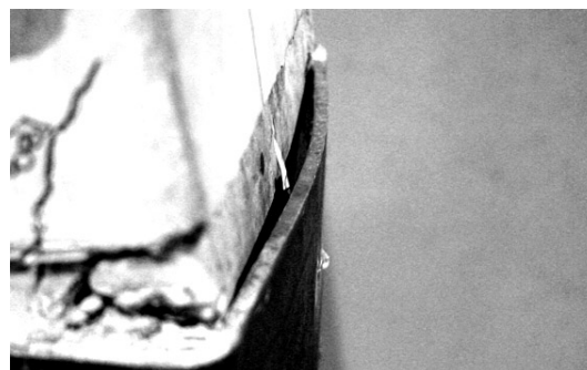
写真 - 3 鋼管がはらみ出した状況 (R-00)
