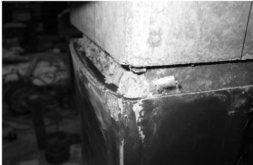
写真 - 2 鋼管が面外方向にはらみ出した状況
