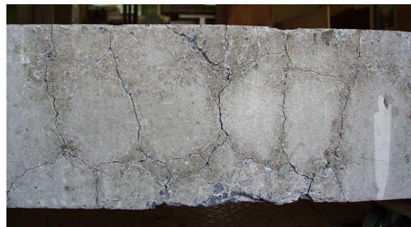
(a) 軽度の損傷：初回補修・補強時の破壊
