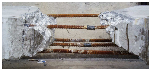
(b) 重度の損傷：3回補修・補強時の破壊
