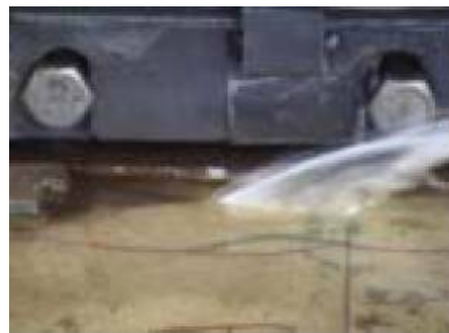
写真-2 水の噴出し状況
