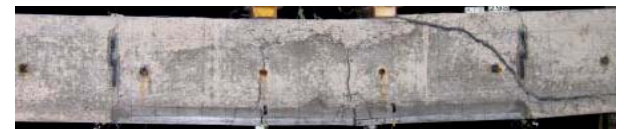
(3) ケース3 (腐食, 断面修復)
