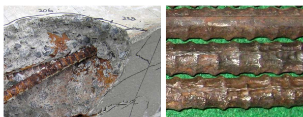
(1) 加力後鉄筋 (2) 腐食物除去後 写真-4 腐食鉄筋の状態
