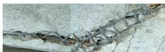
写真-3 ネット試験体のひび割れ面に存在するネット格子位置 (PE-37.5×4.6)
