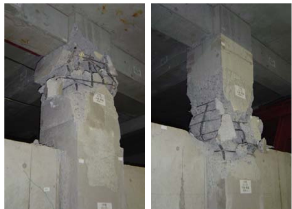
写真-2 1層短柱のせん断破壊（加振5後） （左：X 1 Y 3 柱，右：X 1 Y 2 柱）
