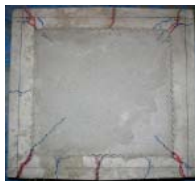
写真-5 断面のひび割れ状況 (No. 5)
