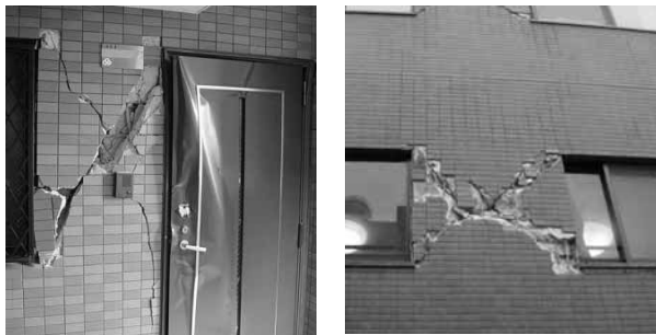
図-1 方立て壁のせん断破壊例(西方沖地震)
