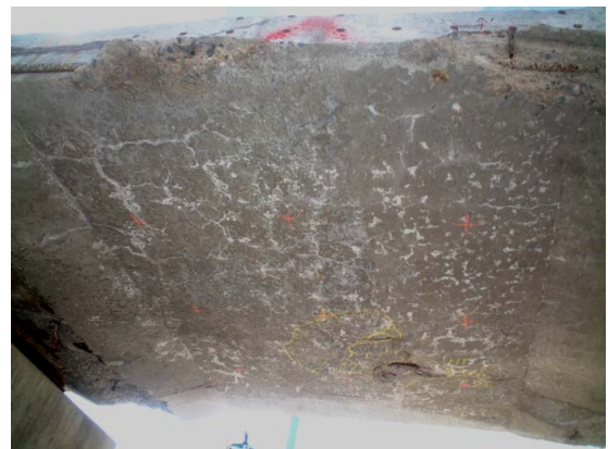
写真-4 遊離石灰の発生状況 (損傷程度大)
