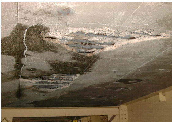
写真-2 床版下面の漏水状況
