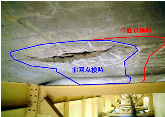
写真-1 床版下面の状況
