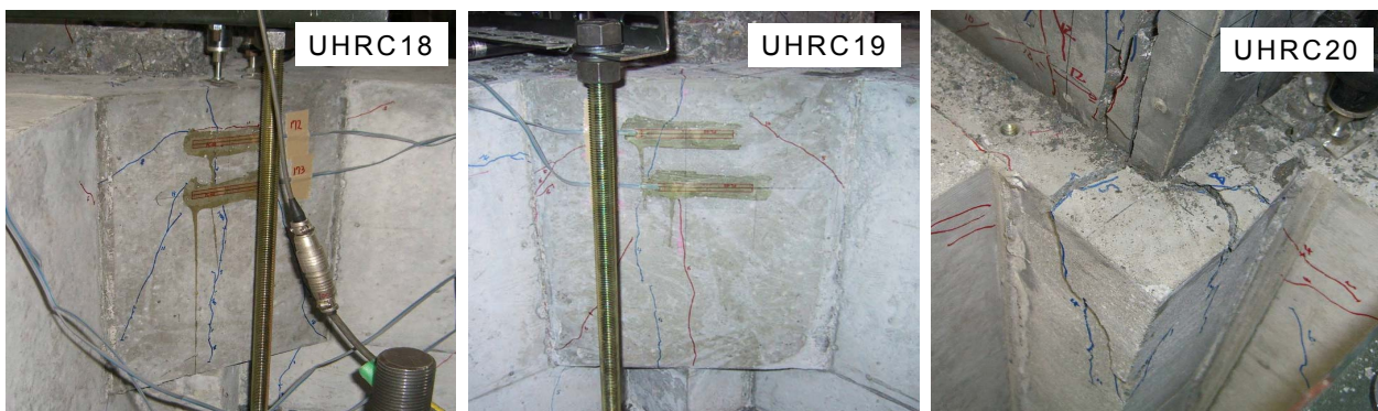
図-7 柱梁接合部ひび割れ状況 (実験終了時)
