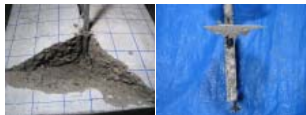
図-5 破壊状況一例
