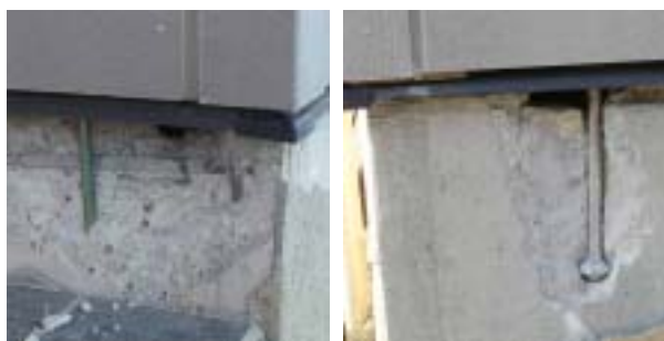
写真-1 RC基礎におけるアンカーの被害
