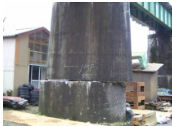
写真—1 新潟県中越地震による被災状況
