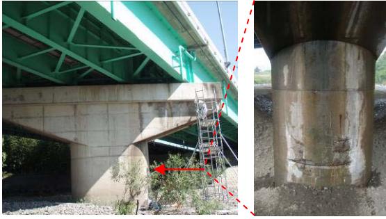
写真-1 T橋の掛違い部橋脚の漏水状況
