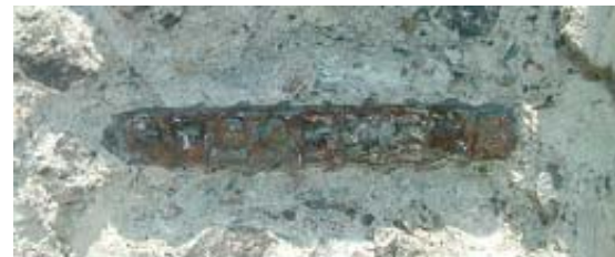
写真-5 鉄筋の腐食状況(WL3,材齢61日)
