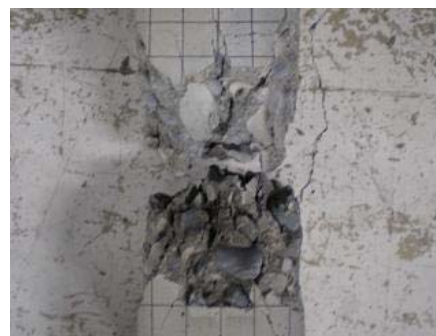
写真-4 粗骨材最大粒径 20 mm の試験体の損傷状況
