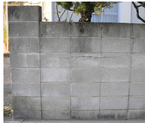
写真-1 ブロック塀の劣化状況
