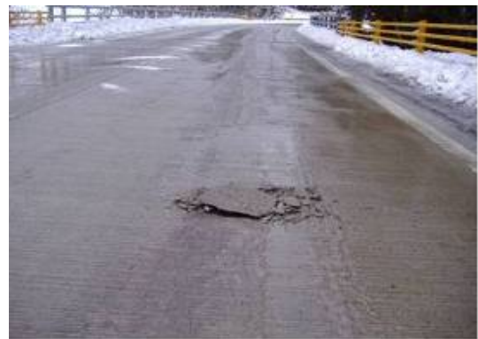
写真-2 コンクリート舗装における剥離損傷
