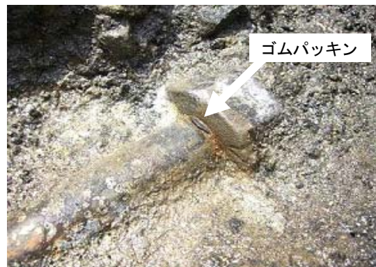
写真-3 ゴムパッキン変状
