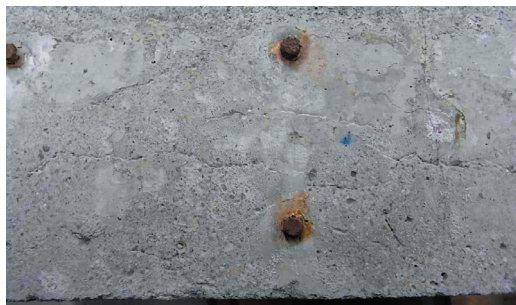
写真-2 層状ひび割れ
