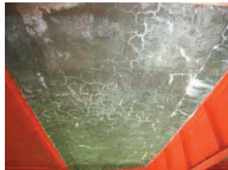
写真-1 劣化床版 2)
