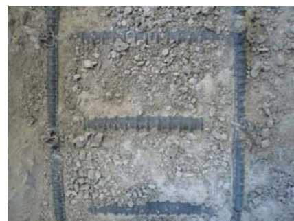
図-6 内部鉄筋の状況(MP1.5)
